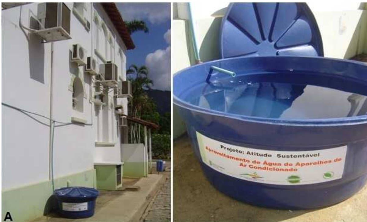
FIGURA 4A – Vista parcial das instalações para captação e armazenamento das águas de ar condicionado. Fonte: Arquivo pessoal, Elvis Pantaleão (2016).
