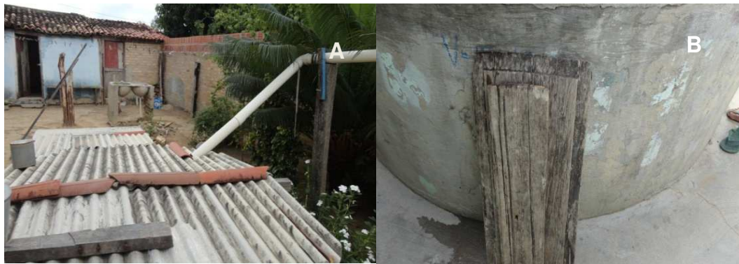
FIGURA 3: Cisternas com má vedação: A- Cisterna com cobertura de amianto e B- Cisterna com tampa de madeira. (Fonte: Elaborada pelos Autores)
