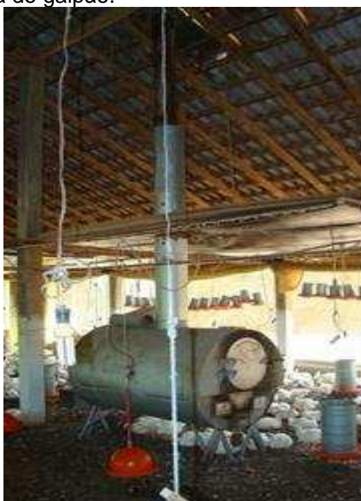
FIGURA 2. Fornalha utilizada para aquecimento do galpão.
