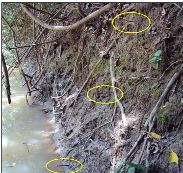
FIGURA 3. Vista parcial da margem direita na seção VI onde foram fixados os pinos.
