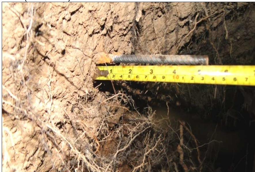
FIGURA 7. Erosão na margem esquerda (côncava) da seção II no pino 2. Fonte: SANTOS, 2012.
