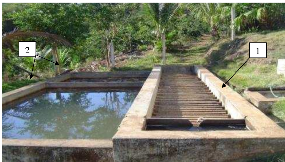
FIGURA 4 – Conjunto de estruturas: (1) floculador e (2) Câmaras de decantação. Fonte: (Os Autores, 2011).
