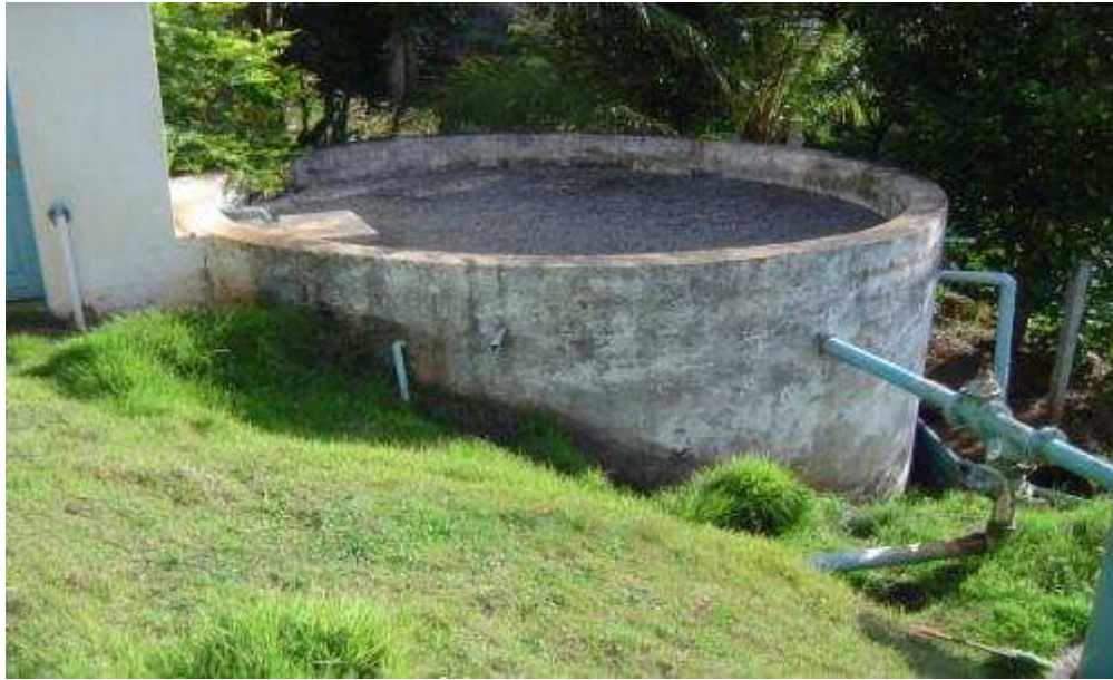
FIGURA 6 – Reservatório semi enterrado, existente na ETA. Fonte: (Os Autores, 2011).
