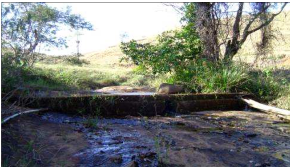
FIGURA 3 - Ponto de captação de água no Rio Vinte Cinco de Julho, em época de seca. Fonte: (Os Autores, 2010).
