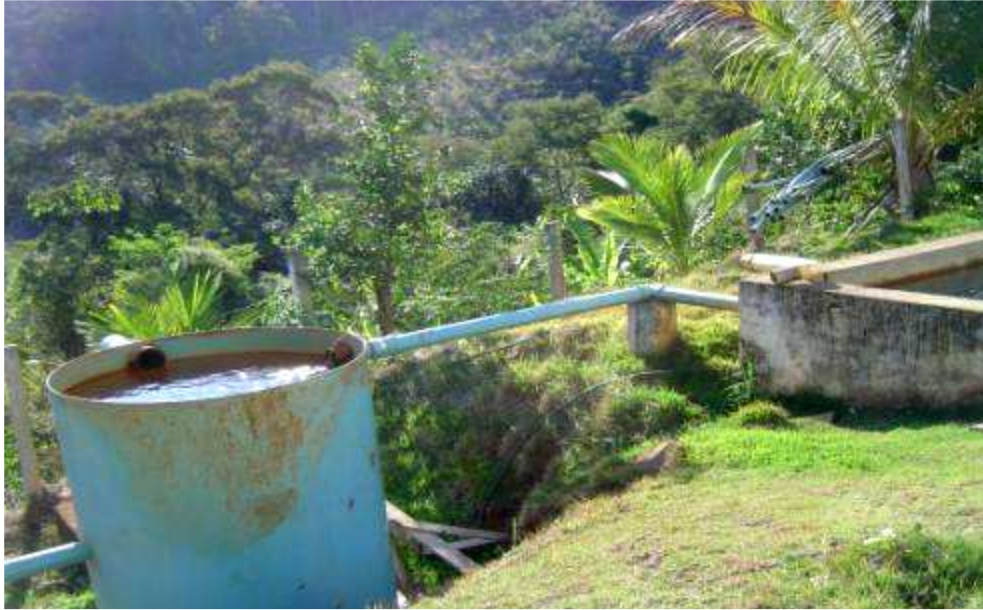
FIGURA 5 – Tanque de filtração. Fonte: (Os Autores, 2011).
