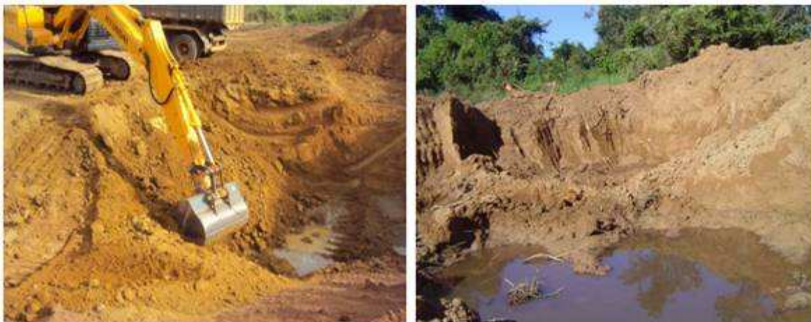
FIGURA 3 – Afloramento do lençol freático em Jazida de extração de argila.
