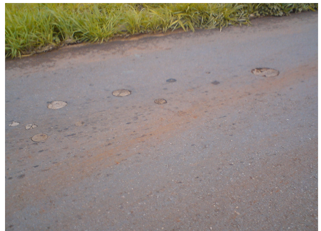
FIGURA 11 – Estado de conservação da pista, novembro 2009. Fonte: SILVA, 2004
