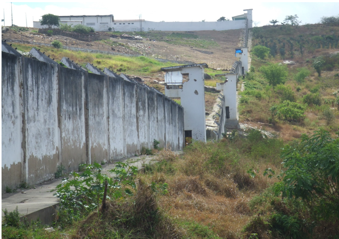
Figura 9 – Estado de conservação dos muros do serrotão.
