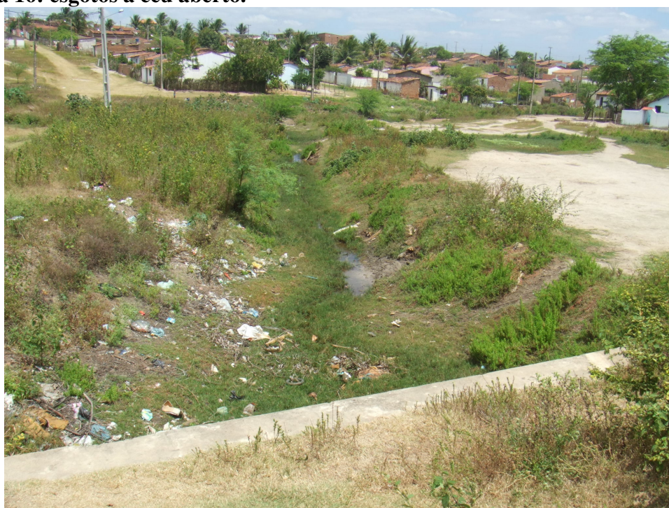
Figura 17: esgotos a céu aberto e infraestrutura deteriorada
