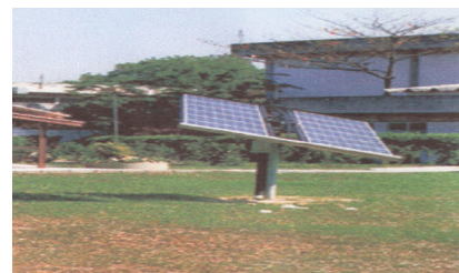
Figura 2.24. Sistema Fotovoltaico Móvel
